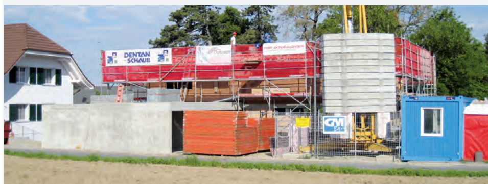
Haldimann AG transporte des containers bleus (à droite), mais aussi des coffrages (au centre) ou des toilettes de chantier (tout à droite).
